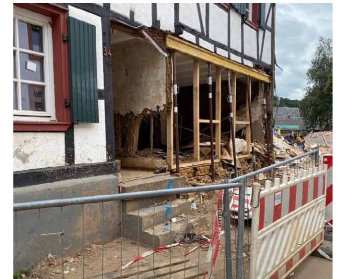
Naturgewalt: Ein Bild der Zerstörung nach dem Unwetter
